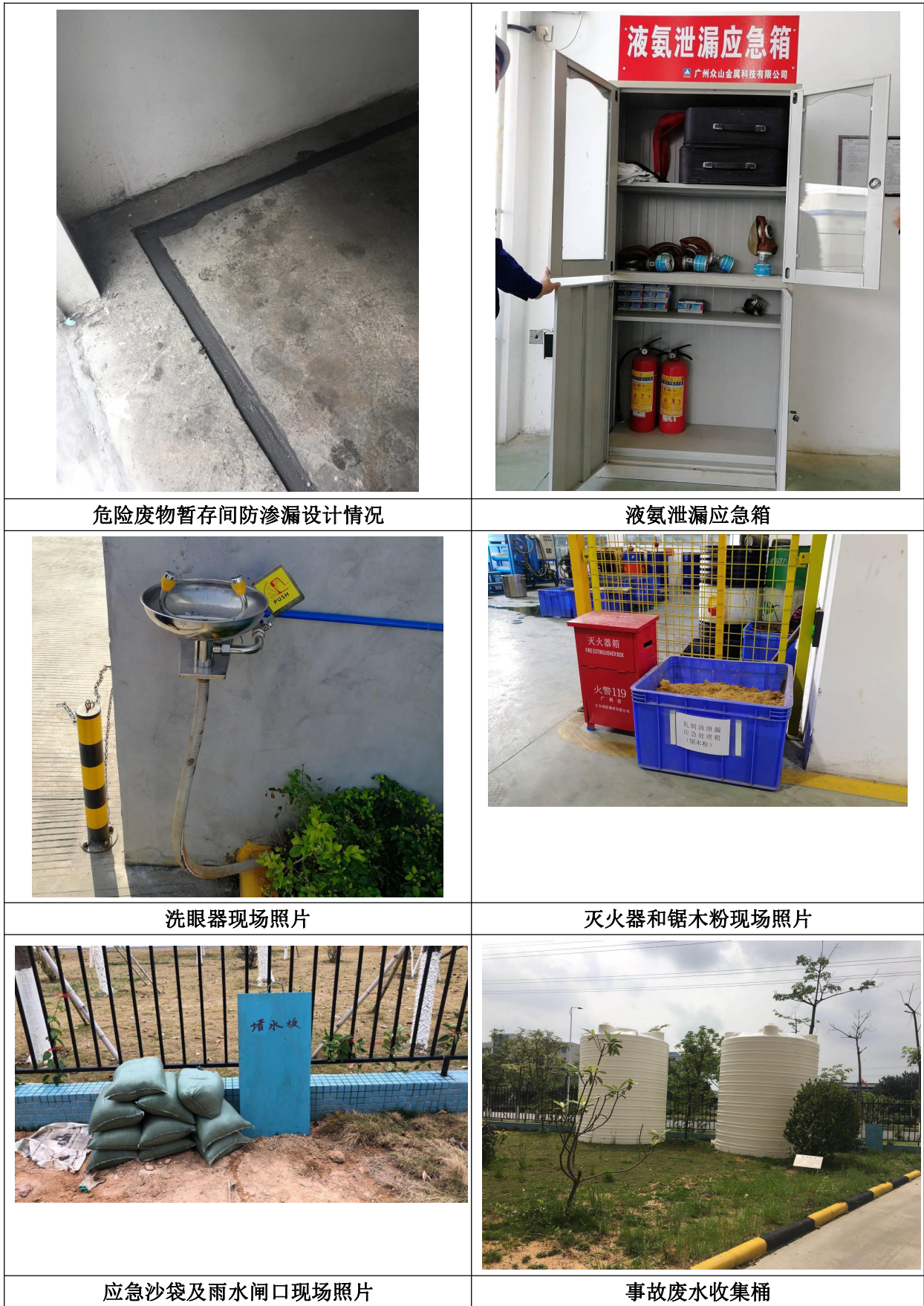
图 4-2 环境风险防范措施照片
